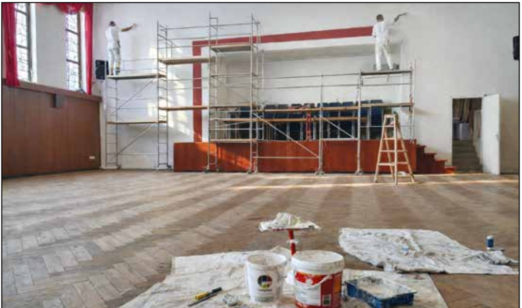
So wird es bald aussehen: Die Visualisierung zeigt Malerarbeiten im Poppelsdorfer Pfarrsaal.
